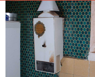
Absence de dispositif d'évacuation des gaz brûlés
