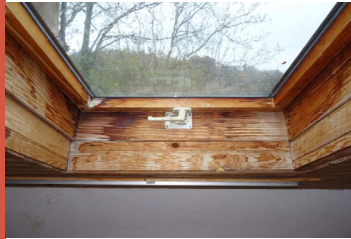
Absence de protection contre les infiltrations d'eau
