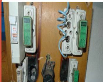
Branchements d'électricité vétustes
