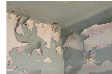
Peinture écaillée contenant du plomb
