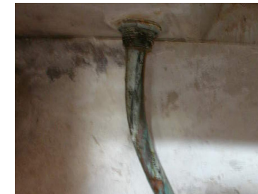
Absence de siphon
