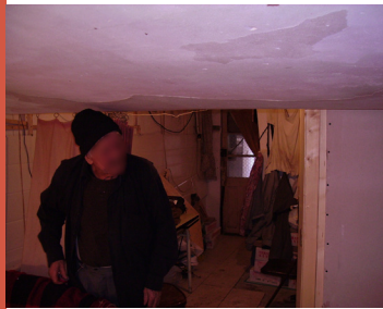
Hauteur sous plafond insuffisante
